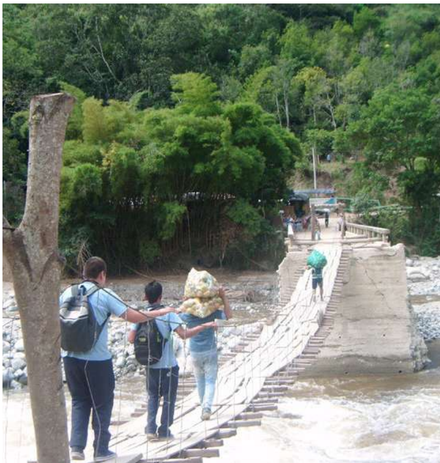
Puente Cambrín, colapsado por el invierno. Los pobladores debían hacer transbordo. Fotografía para el CNMH del archivo fotográfico de la Corporación Casa Teatro Antonio Camacho, 2017.
