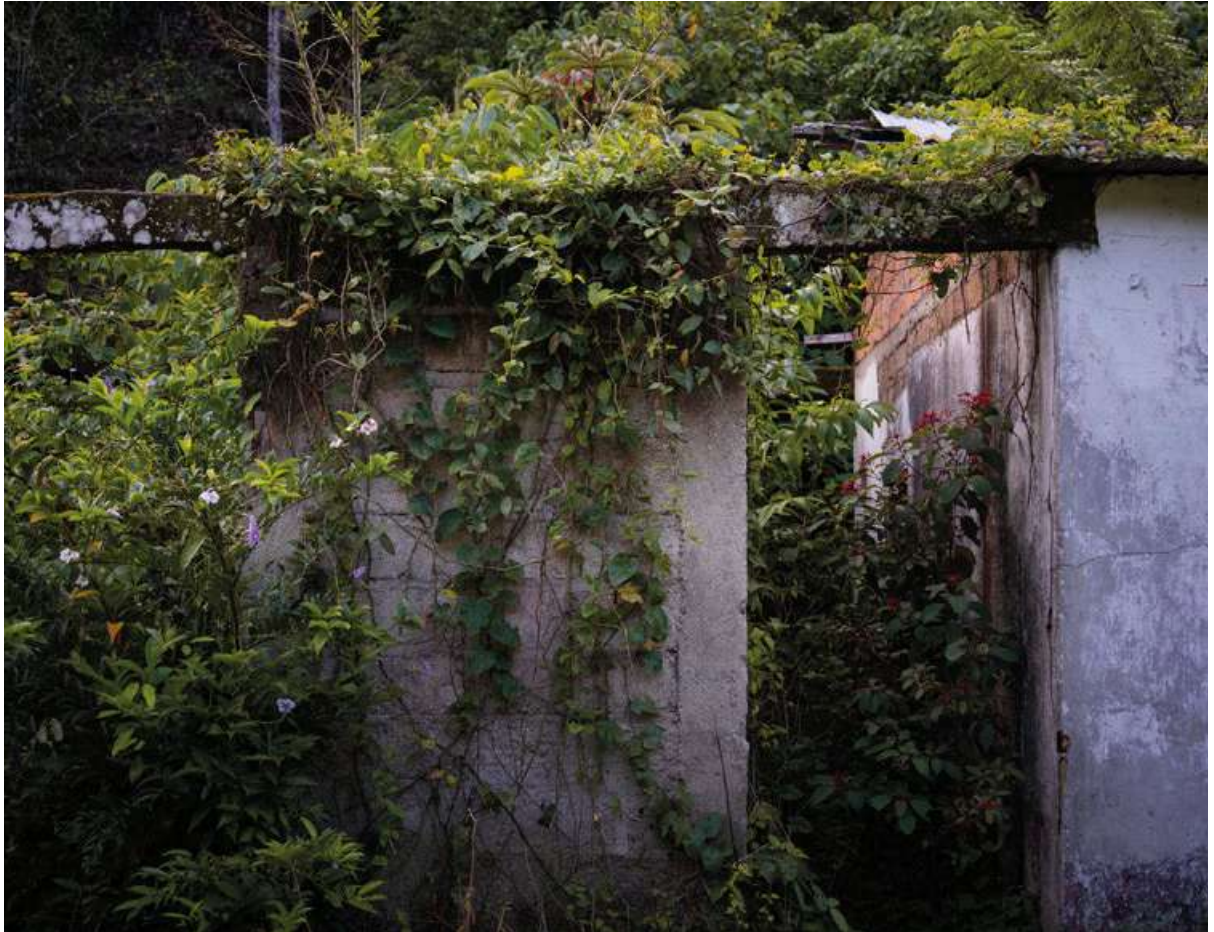
Restos de las viviendas afectadas tras la toma guerrillera del año 2000. Fotografías para el CNMH de Daniel Sarmiento Gómez, 2021.
