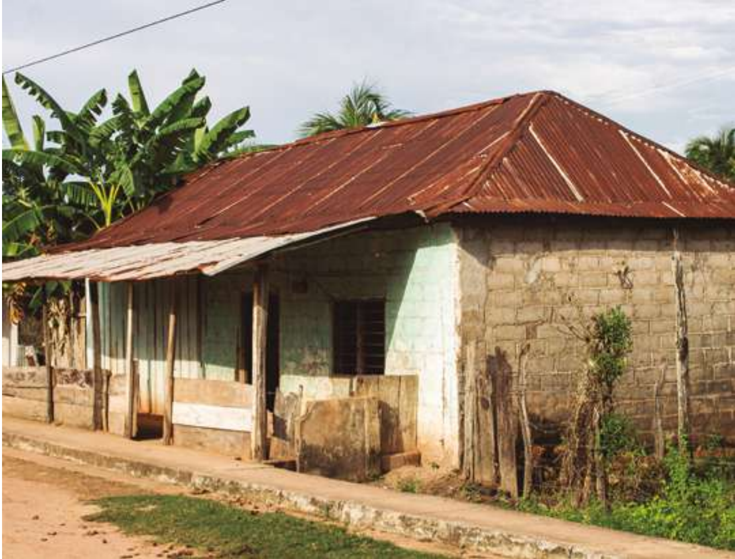
La temperatura y la humedad son tan altas que las fachadas se deterioran rápidamente. Fotografía: Camilo Lozano para el CNMH.
